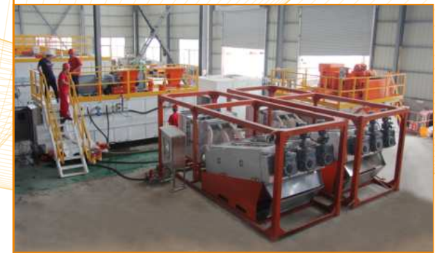
08 污泥脱水系统 Sludge Dewatering System
